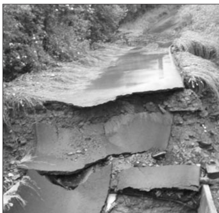
Zniszczony przepust na os. Sukówka w Kasinie Wielkiej
