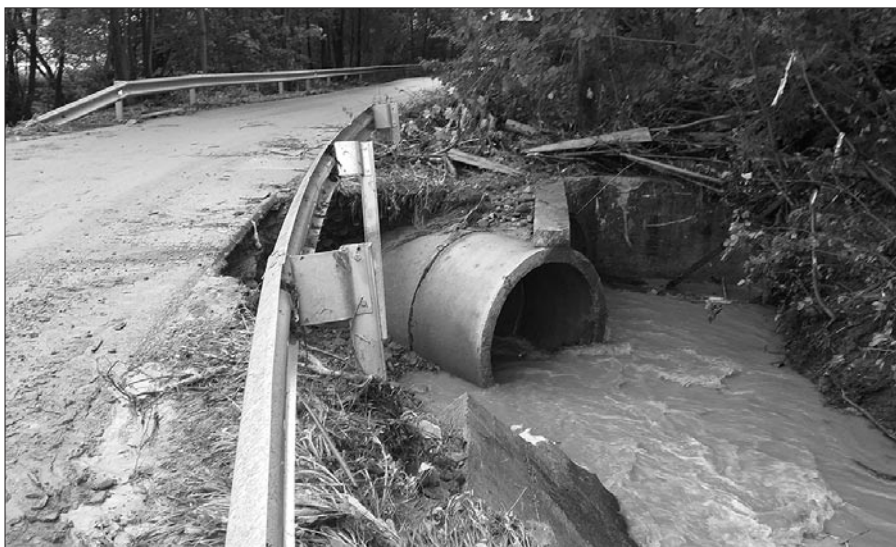
Uszkodzony przepust w Kasince Małej Łopuszne
